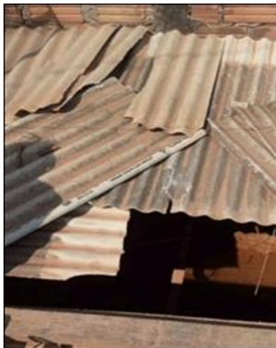
A) Poço com tampa improvisada com telhas de amianto.
