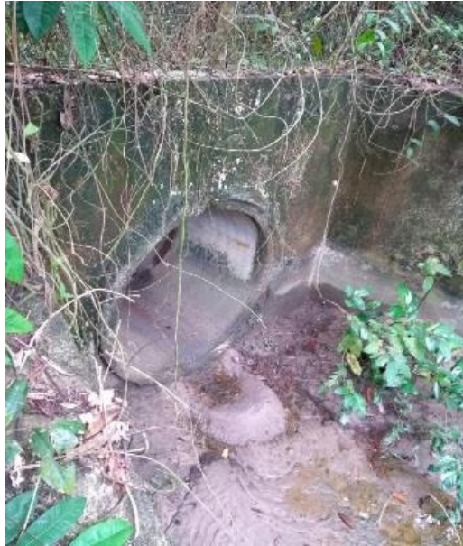
Figura 4 – Esgoto sendo despejado na área de várzea do lago do Macurany sem o tratamento da ETE.
