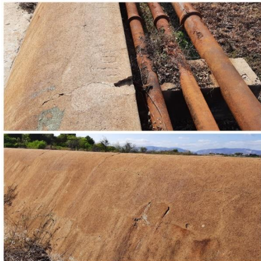
Figura 1 – Desgaste identificado na estrutura do sangradouro do açude Jatobá, Patos, Paraíba.
